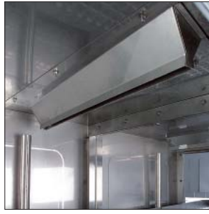
Die oberen Ausblasöffnungen des Trockentunnels wurden unter einem Winkel angebracht, um das Entfernen von Wasser von allen Arten von Oberflächen zu optimieren.
